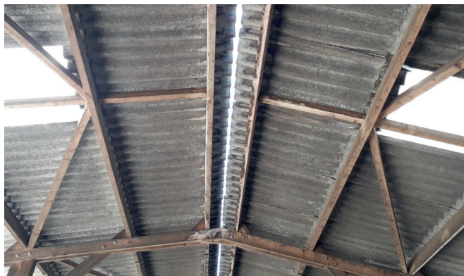
Photo 18 - Un manque d'ouverture du faitage au-dessus des logettes Des pannes faitières avec des traces d'humidité
